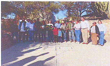
Pavimentación ecológica en calle Benito Juárez del Remudadero de Abajo 641.54 metros cuadrados Inversión: 526 mil 442.99 pesos
