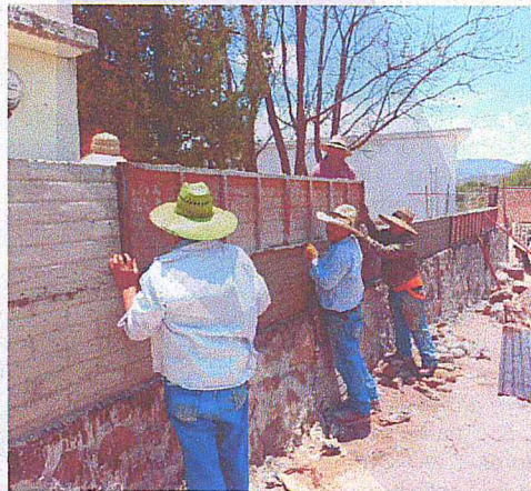
El equipo operativo de Obras Públicas construyó el muro perimetral con formas de concreto en el Jardín de Niños 'José Vasconcelos' de Arellanos, para mayor seguridad de los alumnos.
